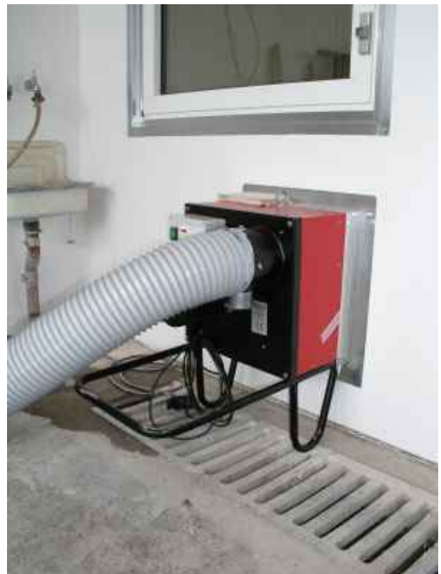
Abb. 5.3 - 8 Einer der beiden Hochleistungsraumlüfter
